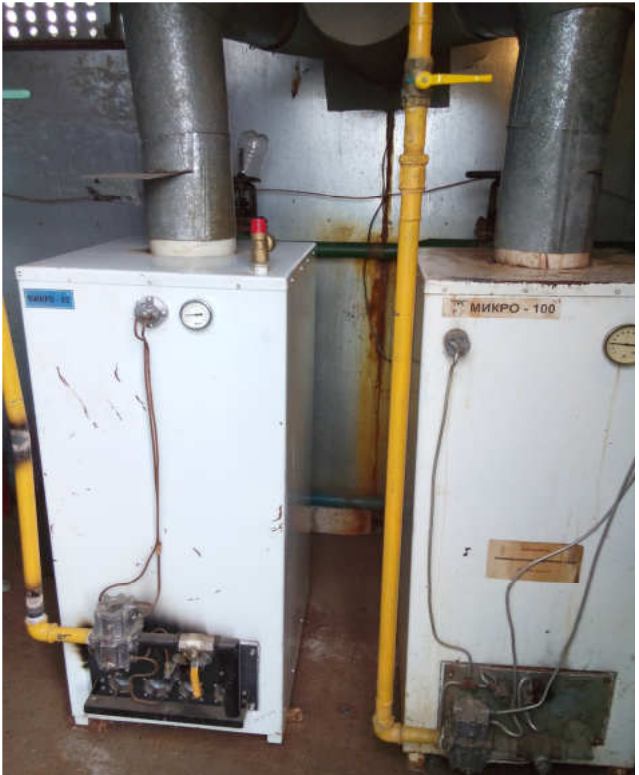
Видимое изображение №3 Трубопроводы обвязки котлоагрегатов
